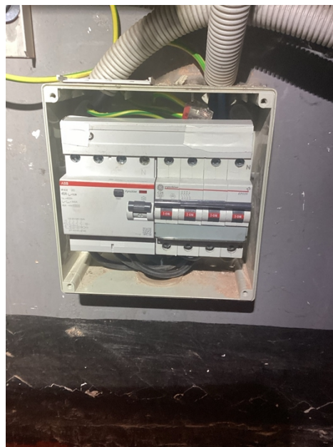
( Elektrisch bord - binnenkant )
